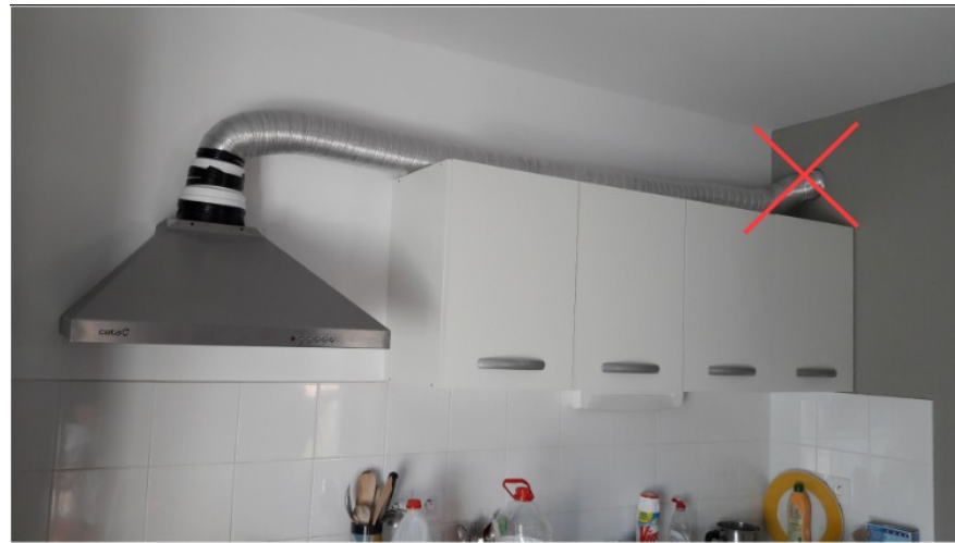
Hotte de cuisine motorisée raccordée au réseau de ventilation d'extraction Configuration d'installation non-admise – nécessite le retrait du raccordement
