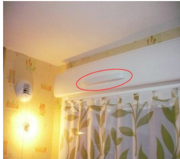
Présence d'une entrée d'air dans une cuisine (pièce de service) – Disposition non conforme
